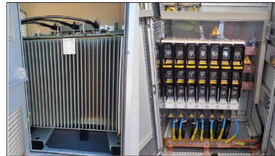
Figure 29 : Transformateur BT/HTA et TGBT 800 Vac à fusibles (Source : SOG SOLAR)
