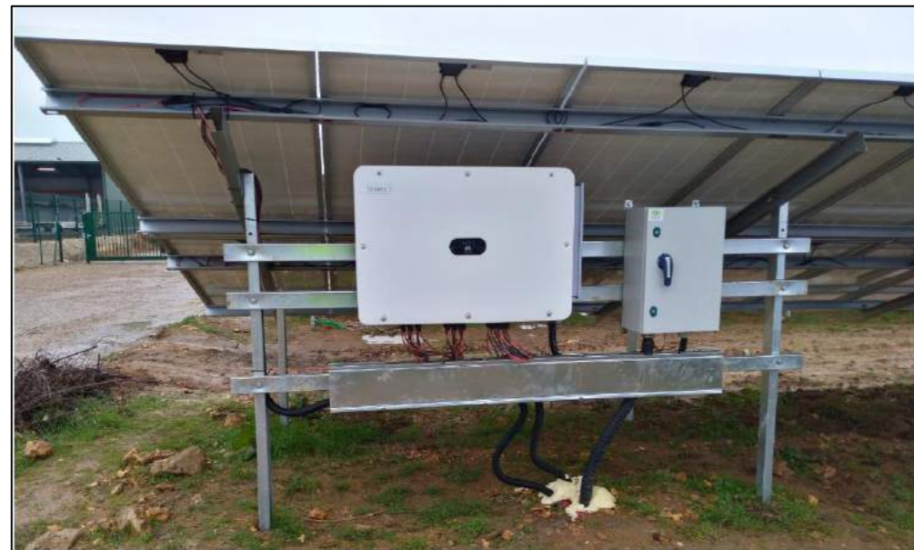
Figure 31 : Onduleurs photovoltaïques fixés à la structure porteuse des modules (Source SOG SOLAR)
