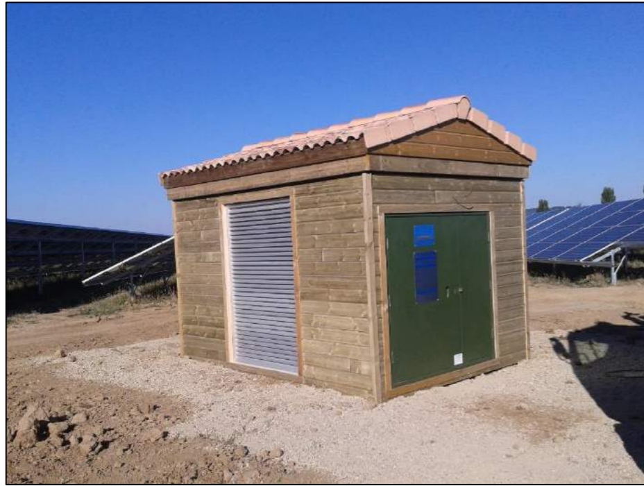
Figure 27 : Poste de transformation en bardage bois (Source : BOISECO)
