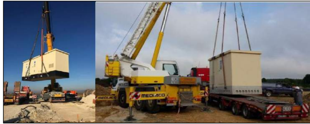
Figure 30 : Grutage d'un poste de livraison et d'un poste de transformation (Source : SOG SOLAR)
