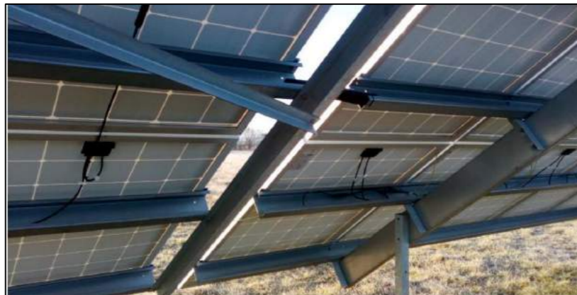
Figure 25 : Exemple de chemins de câbles aériens (Source : SOG SOLAR)
